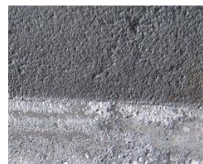
Fig: 5 Rough surface
