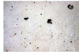
Fig: 1 Blow holes
